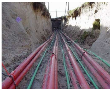
Figuur 4.3: Kabels en leidingen
